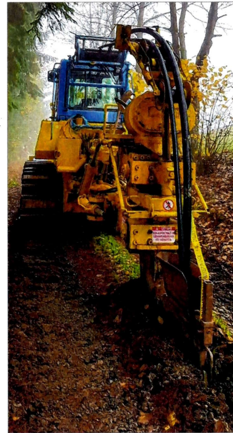
Die Firma Berge Bau verlegte kürzlich das Stromkabel zur Schanze. Foto: Verein
